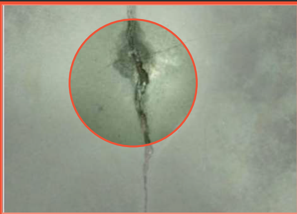
Vết nứt trên sàn nhà
