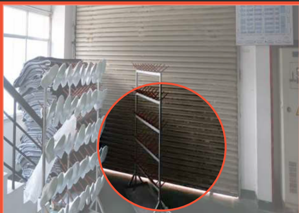
Lối thoát hiểm bị chặn
