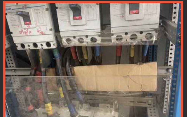
Vật liệu dễ cháy để trong tủ điện
